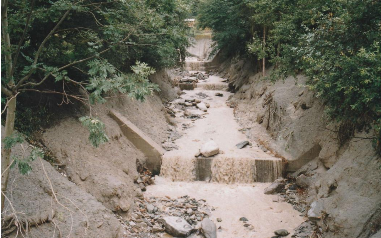
Abbildung 2: Fotoaufnahme von Pierino Casutt des Bachlaufs nach dem Murgangereignis im Jahre 2004. Bei diesem Ereignis traten grössere Schäden an Gebäuden und Flur auf.
