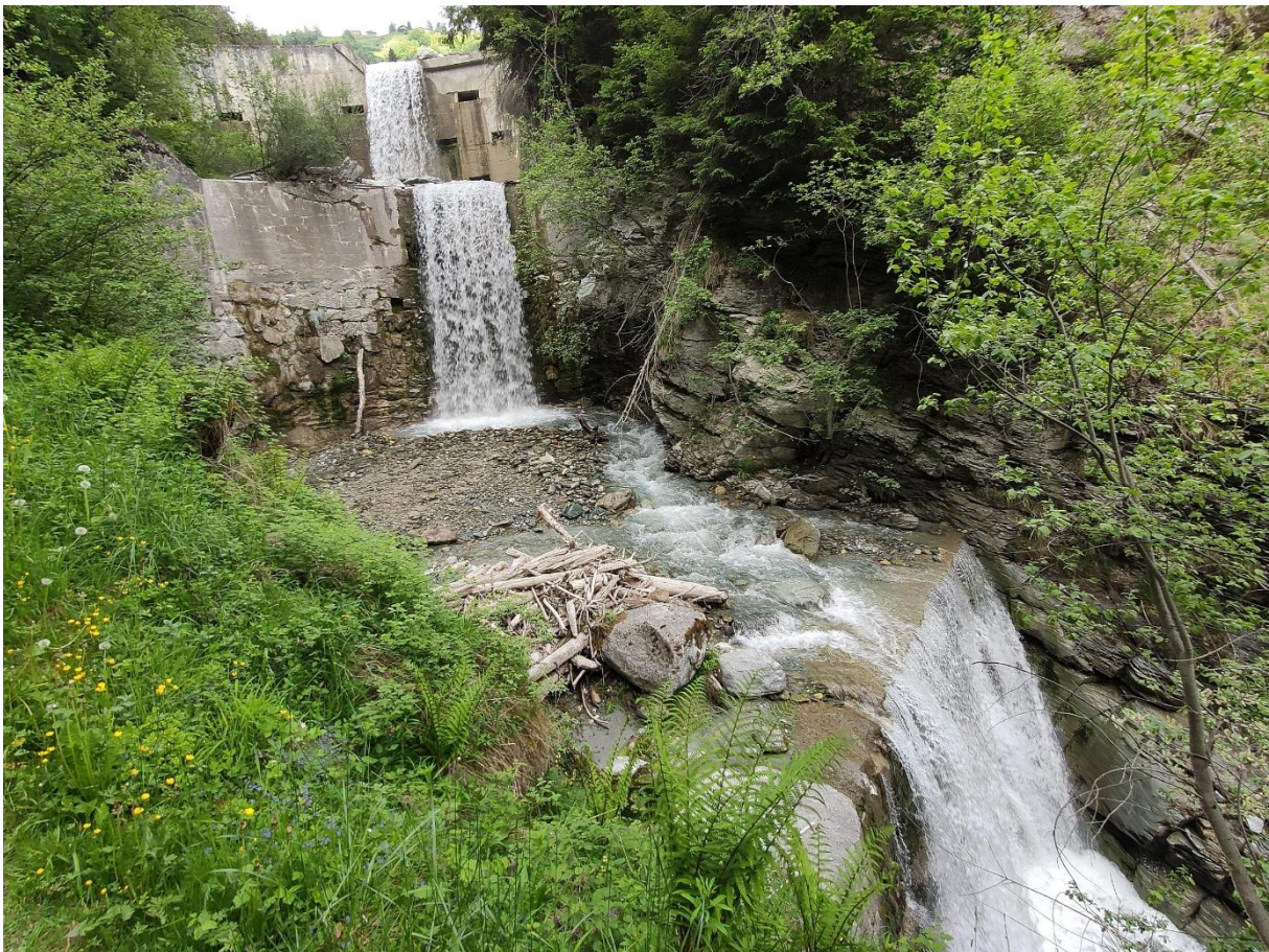
Abbildung 12: Foto der zu instandstellenden Sperrenkaskade in Parlet, 20. Mai 2020.
