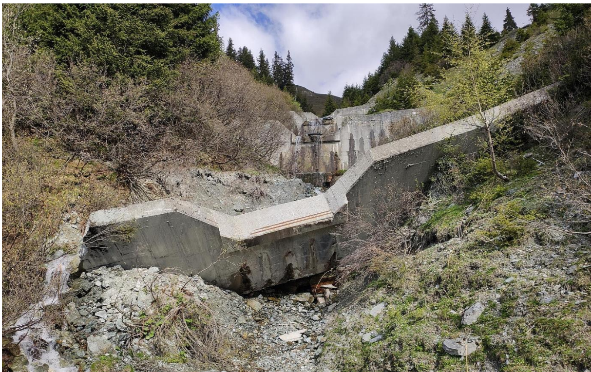
Abbildung 1: Beispielfoto einer defekten Sperre im Perimeter des Projektes Val da Schluein, 20. Mai 2020.
